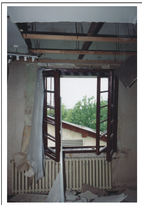
Od snažnih detonacija stradale su sve prostorije arhiva
